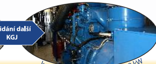
kogenerační jednotka do 300 kW
