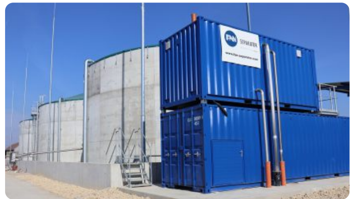
Technologie FAN BRU a zastřešené jímky.
