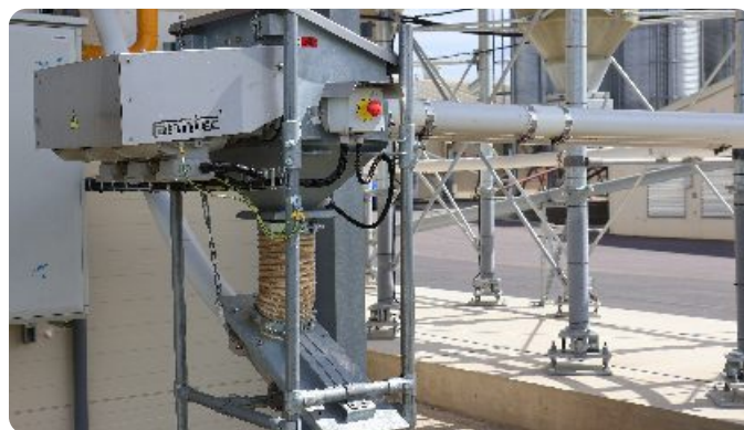
U zásobníků krmiv jsou přesypová místa
