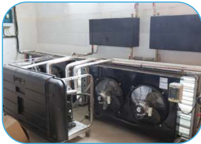
technické zázemí k chladicímu tanku, rekuperace tepla
