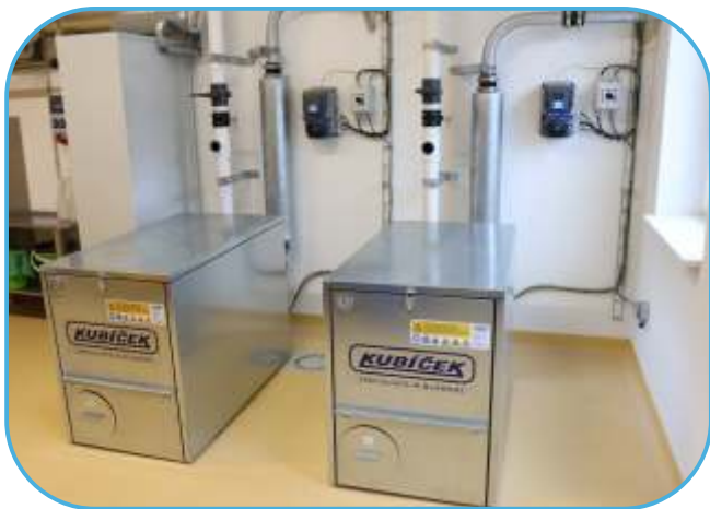
dmychadla v izolovaných boxech s frekvenčním měničem
