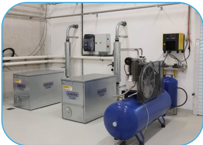
dmychadla v izolovaných boxech s frekvenčním měničem
