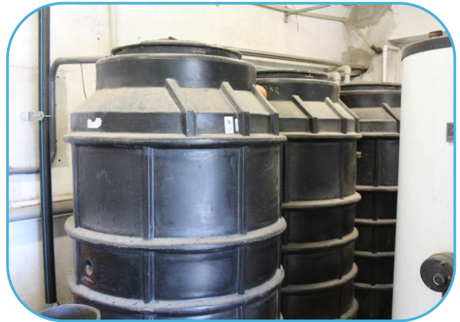
nádrže na odpadní vody z proplachu mléčného potrubí
