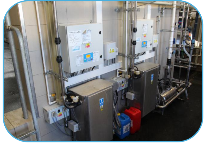
čerpadla mléka a desinfekční automaty
