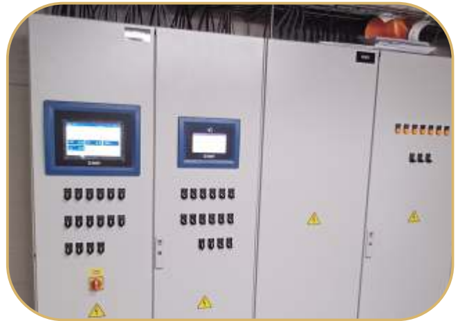
rozvaděče s integrovaným klima a produkčním počítačem
