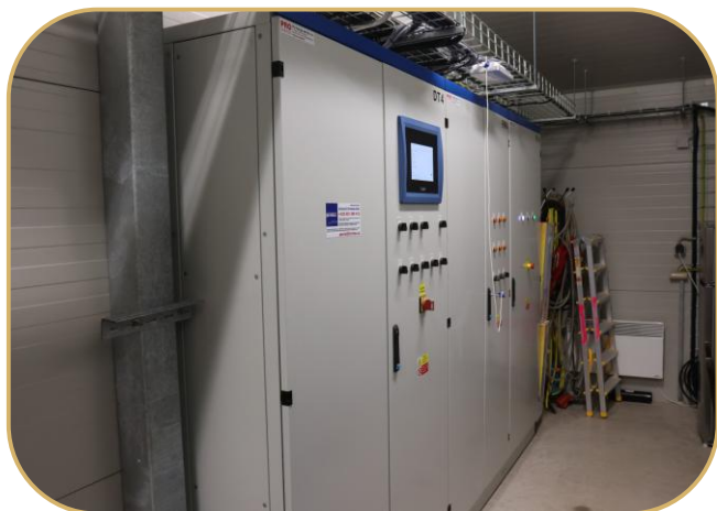
rozvaděče s integrovaným klima a produkčním počítačem
