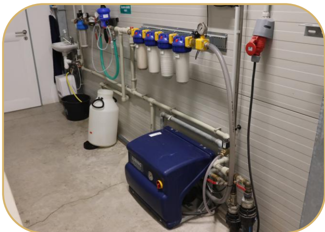
medikační uzel, čerpadlo vysokotlakého chlazení
