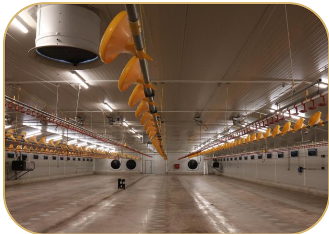
podtlaková ventilace s tunelovými prvky v hale č.4
