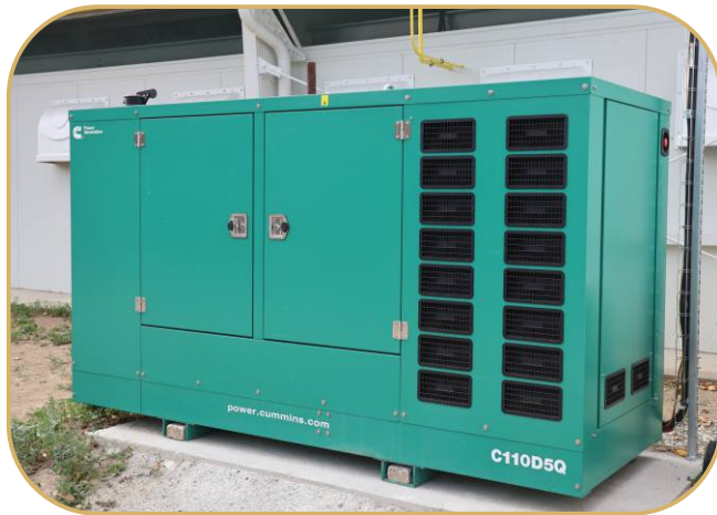
náhradní zdroj dieselagregát v kontejnerovém provedení
