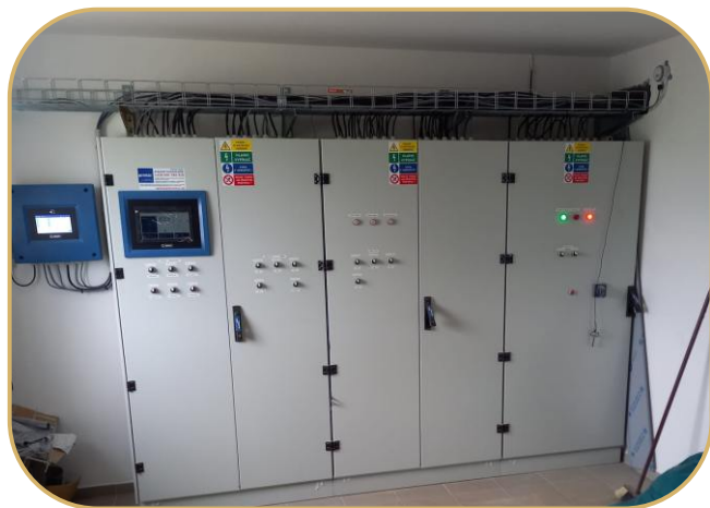
rozvaděč s integrovaným klima a produkčním počítačem
