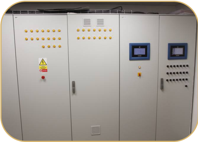
systém řízení klimatu s využitím vzdálené správy
