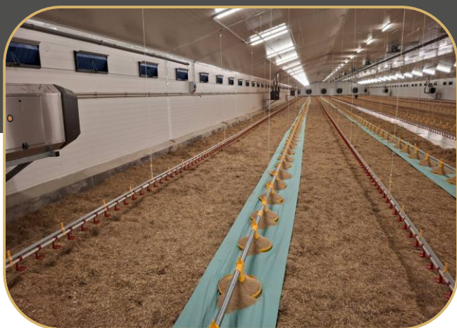
elektricky zvedané krmné a napájecí linky
