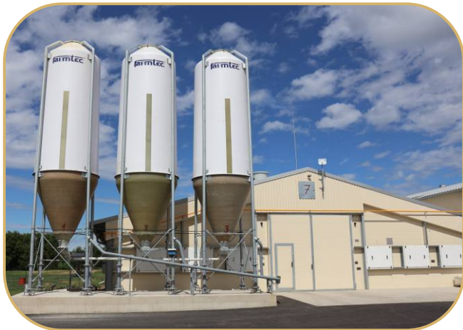
sklolaminátové sila vč. tenzometrů, tunelové klapky ve štítu
