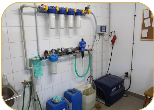
medikační uzel, čerpadlo vysokotlakého chlazení
