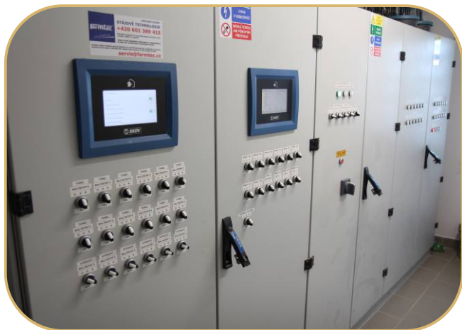
rozvaděče s integrovaným klima a produkčním počítačem
