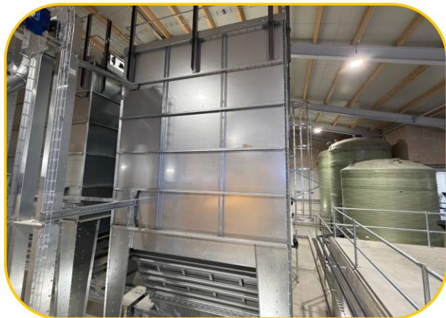
vnitřní modulární sila pro uskladnění krmiv
