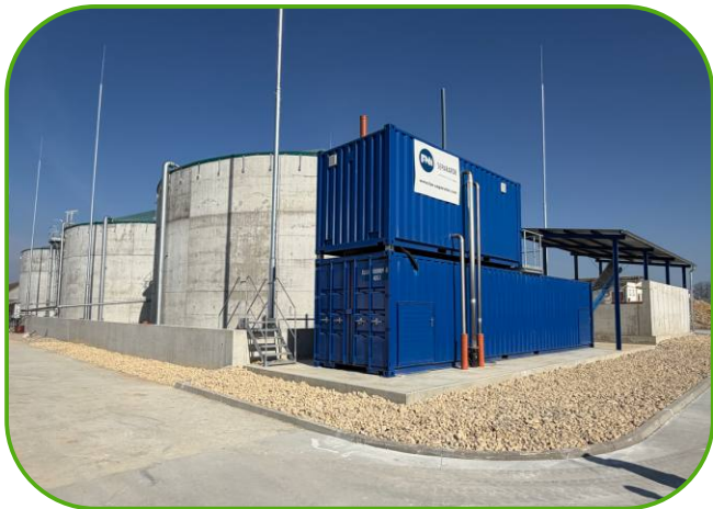
zastřešené skladovací jímky na kejdu a zařízení FAN BRU
