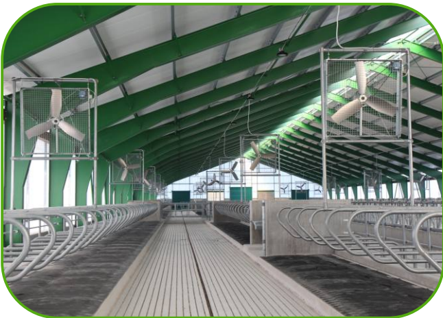
axiální ventilátory nad lehacími boxy
