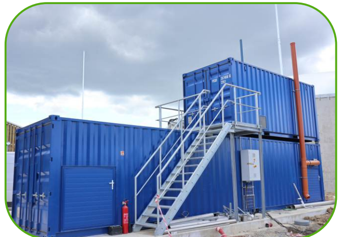
zařízení FAN BRU - pro separaci kejdy a další úpravu separátu
