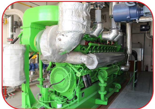
kogenerační jednotka GE Jenbacher na zemní plyn (CNG)
