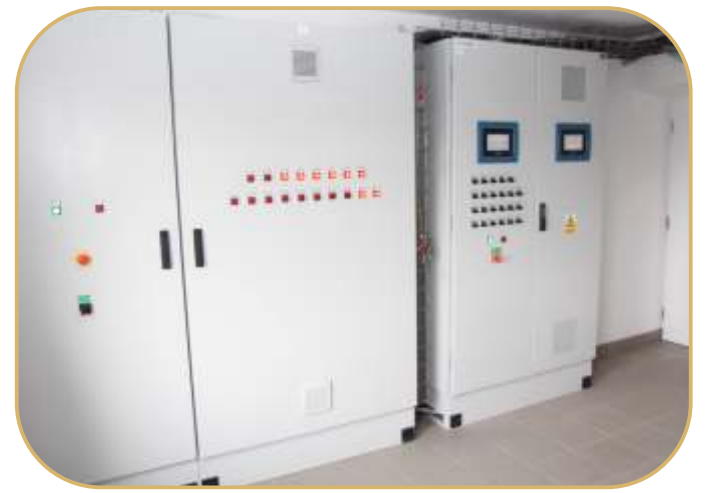
silový a řídicí rozvaděč s klima a produkčním počítačem
